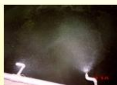
散水設備の例
