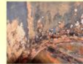
砂ろ過塔腐食状況
