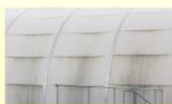
被覆施設の膜面の汚れ
