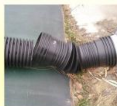
ガス抜き管の破損例
