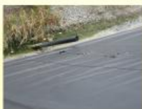
法面ガス抜き管の破損
