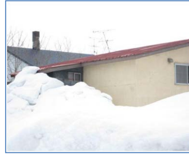
住宅の軒先損傷
