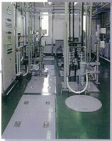
●浸出水処理施設内部
