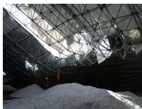
図 2-5 棟中央の座屈
