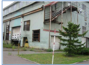
外壁面の損傷
