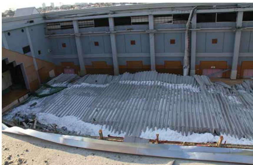
図 2-12 A 市の体育館 被害状況
