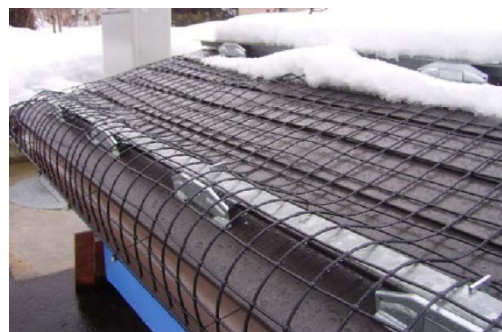
図 1-7 電熱装置を軒先のみ設置
