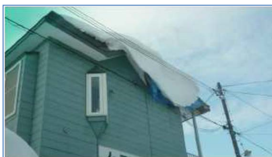
住宅の軒先損傷
