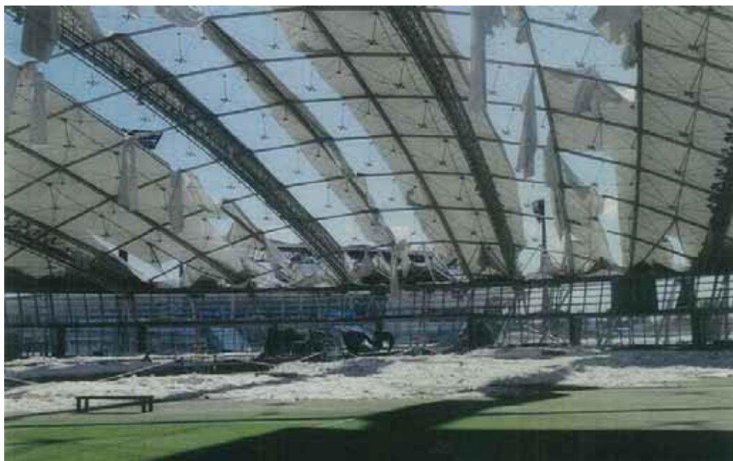
図 2-14 D市の運動施設 被害状況
