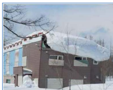
小屋組損傷（空き家）
