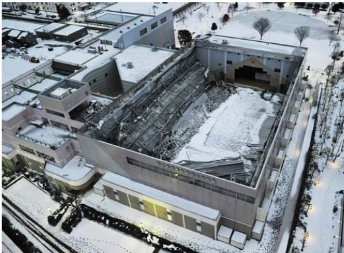
屋根が崩落した埼玉県富士見市の市民総合体育館＝埼玉県富士見市
