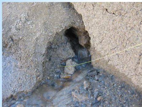
(a) 土層底部からの噴出水
