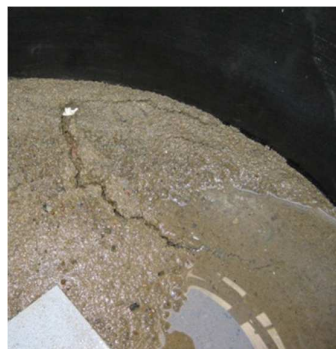
(b) 亀裂の状況
